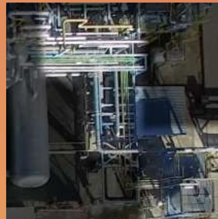
Sistema Depuración de Aceites
